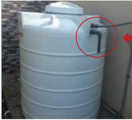
أنبوب التحذير من الطفح Overflow warning Pipe
